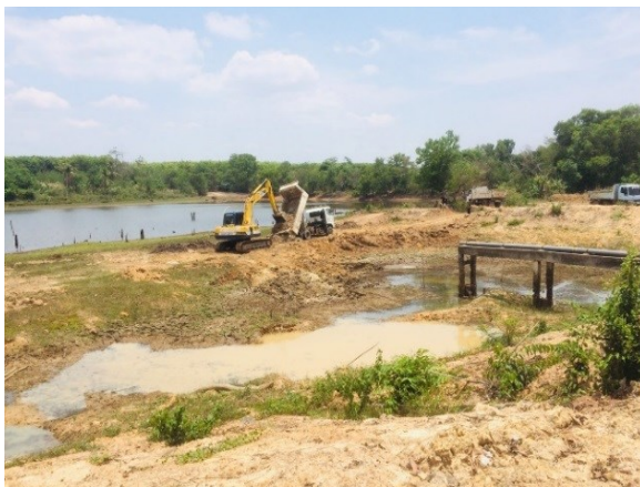
อ่างเก็บน้ำห้วยมะไฟใหญ่ บริเวณที่มีการขุดลอกจุดสูบน้ำ และปรับระดับวาล์วหัวกะโหลกสูบน้ำ
